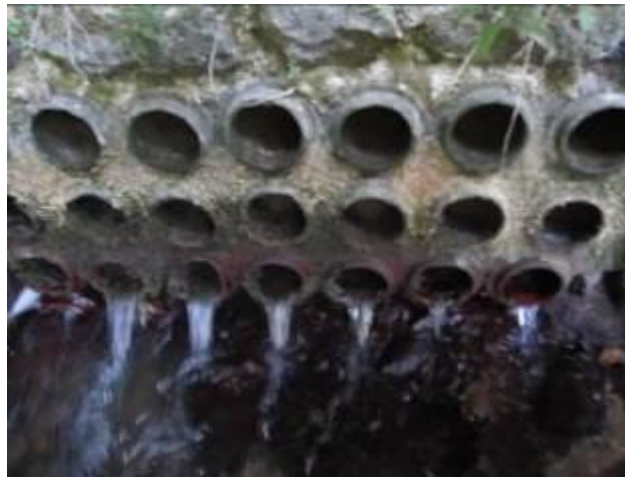
Figure 24 : Exhaure des galeries des mines de Privas - Coux
